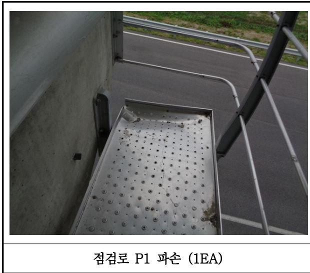
【사진 42.3.26】 교량 점검시설 손상현황
